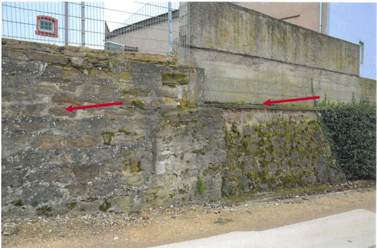
Bild 2: Stützmauer von 1956/1957 mit Übergangsbereich (links) Pfeilerbereich vermutlich unsaniert, stark verkippt (Abschnitt 2); geplante Abbruchbereiche (UK) markiert
